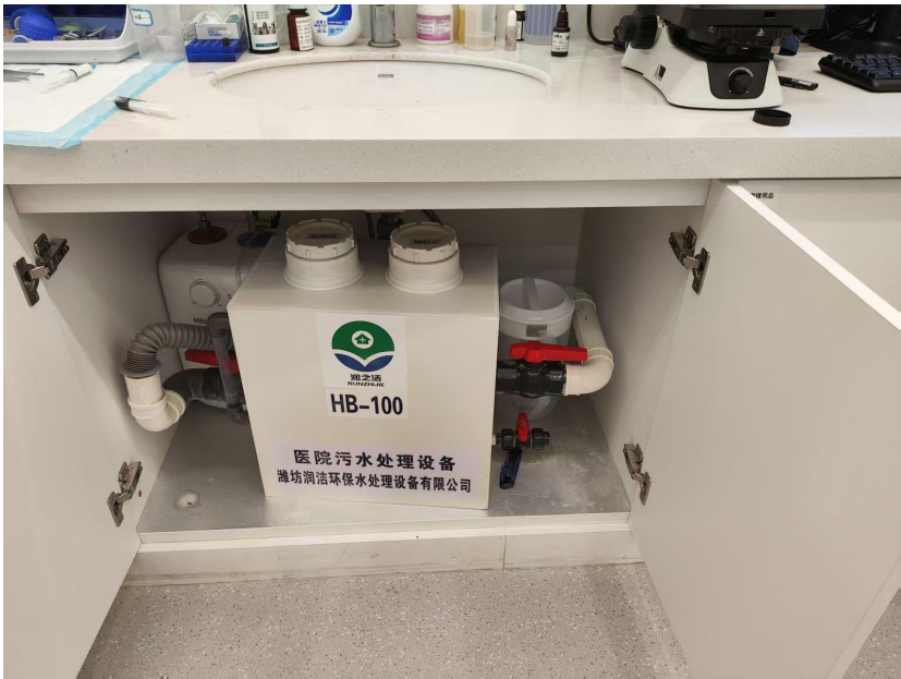
图 3-2 化验室小型医疗废水处理设施照片
